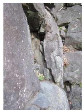
石材前面が崩落 しつつある石材
